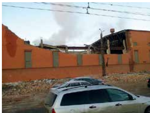
Рис. 2.19. Разрушенная стена Челябинского цинкового завода (из архива МЧС)
