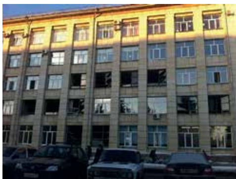
Рис. 2.17. Повреждения окон зданий Челябинского университета (из архива МЧС)
