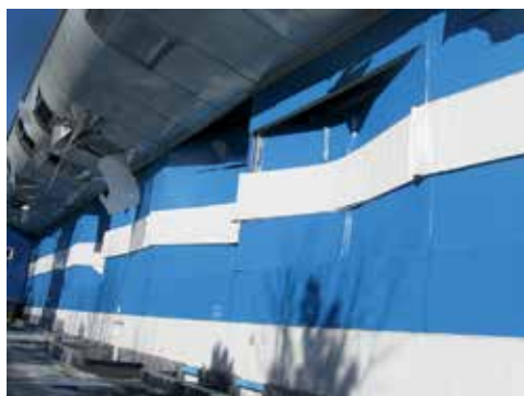
Рис. 2.18. Повреждения наружных конструкций здания СК «Уральская молния»
