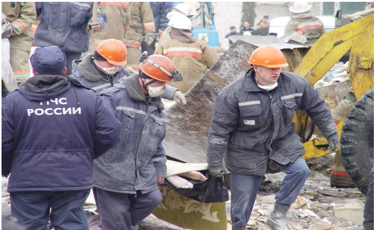
Фотография 3.5. Разбор завала подъезда после взрыва в г. Архангельске.
