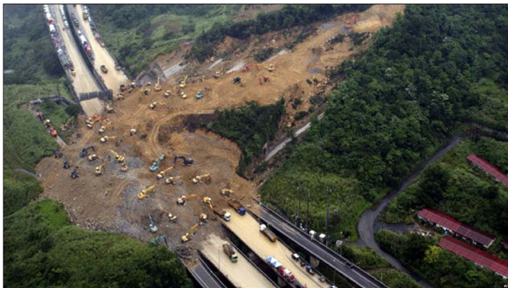
Рис. 4.5. Сход оползня и его последствия
