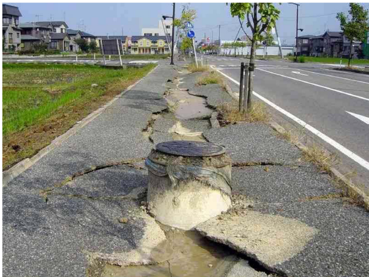
Рис. 2.6. Повреждение или разрушение систем тепло- и водоснабжения
