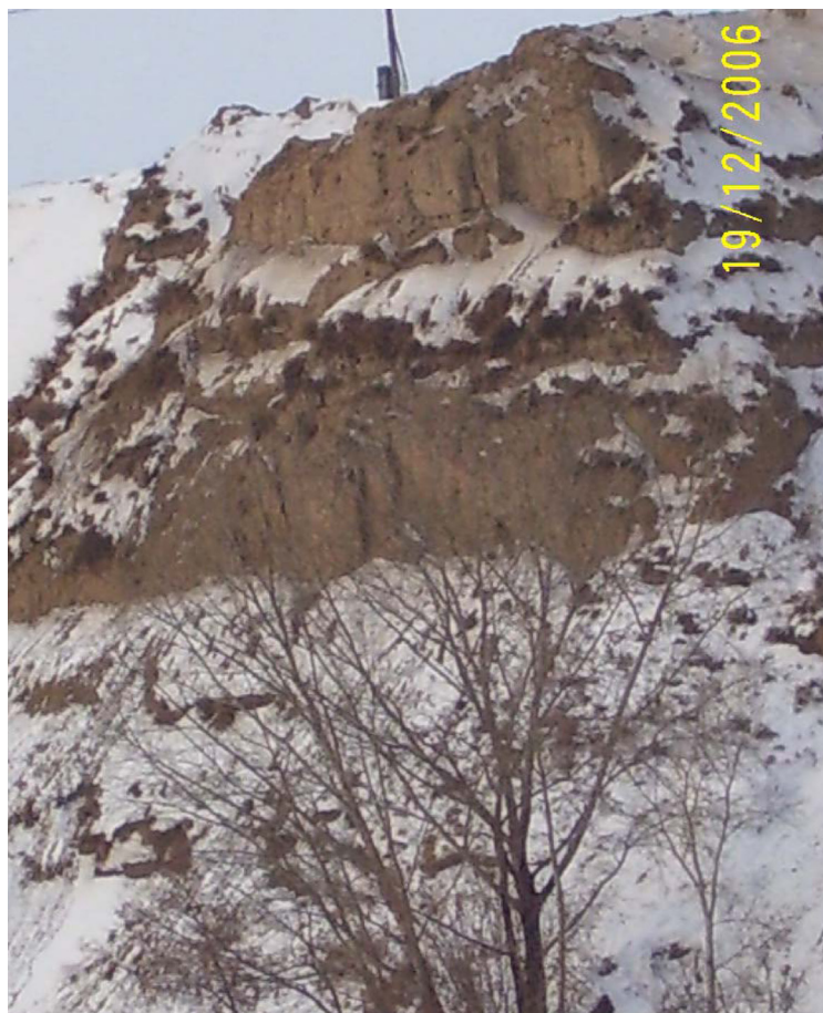
Рис. 4.3. Оползнеопасный склон в районе строительства торгово-развлекательного комплекса «Июнь»
