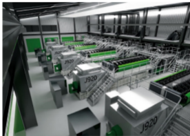
Рис. 11.3. Машинный зал испанской электростанции, работающей на коксовом газе
