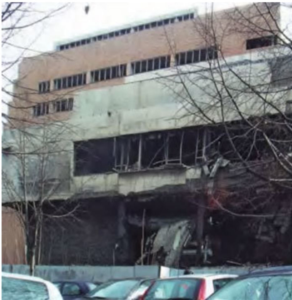
Разрушенные здания Министерства обороны в Белграде
