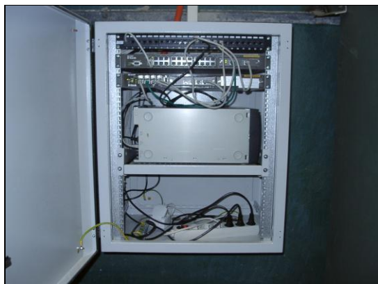
Рис. 3.3. Шкаф с сетевым оборудованием
