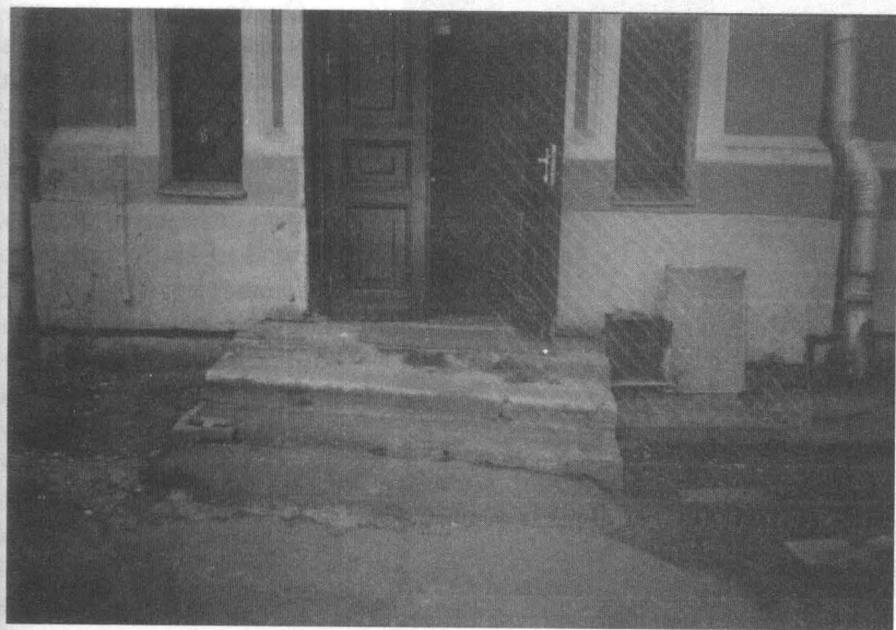
Рис. 5. Просадки асфальта над ложбиной стока у входа в боковой флигель МАРХИ. Фото Э.А. Лихачёвой 07.05.2003 г.
