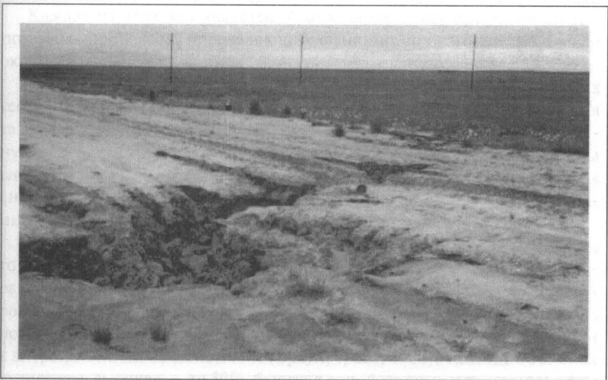
Рис. 11. Перехват — встречный рост промоин, заложившихся по морозобойным трещинам на насыпи автомобильной дороги. Фото В.И. Евдокимова
