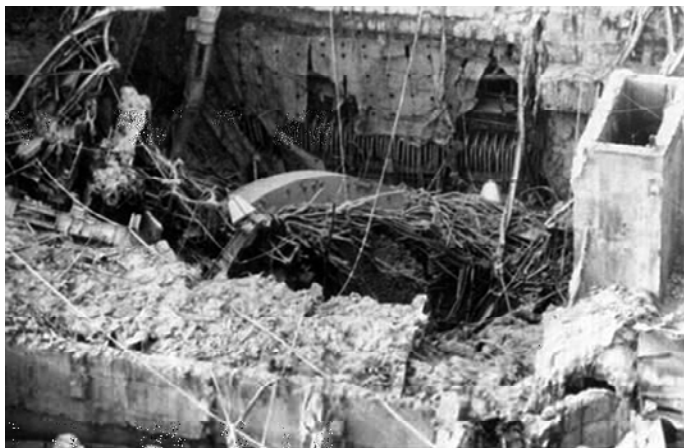
На фото виден край Схемы «Е» с оторванными трубами. Она ничем не засыпана.
