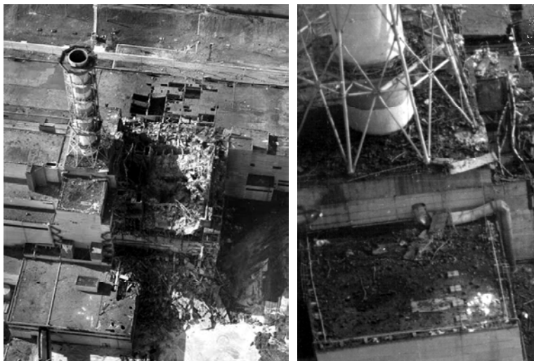
Фрагмент участка №2 — кровля рядом с блоком №4 (фото слева). Видны фрагменты активной зоны, выброшенные во время аварии на кровлю здания блока В, на котором стоит вентиляционная труба. Вид дан с северной стороны; справа расположен разрушенный реакторный зал блока №4, слева — кровля реакторного зала блока №3. На правом снимке — более крупный план одной из кровель.
