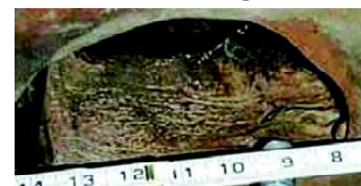
Фото коррозионной каверны в крышке реактора Davis – Besse. Глубина каверны – 15 см, длина – 18 см, ширина – 12 см.
