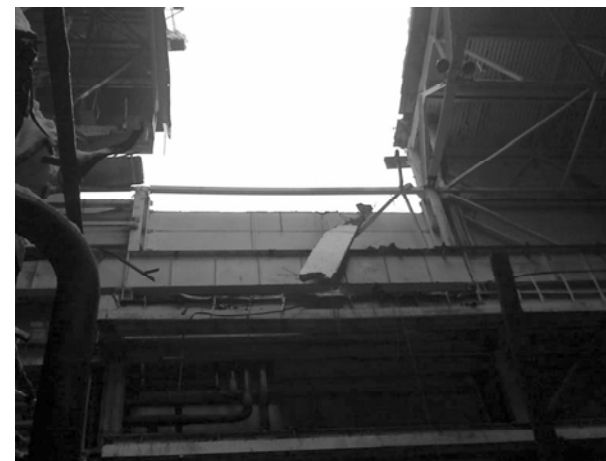
Дыра в кровле машзала ЧАЭС (12.02.2013)
