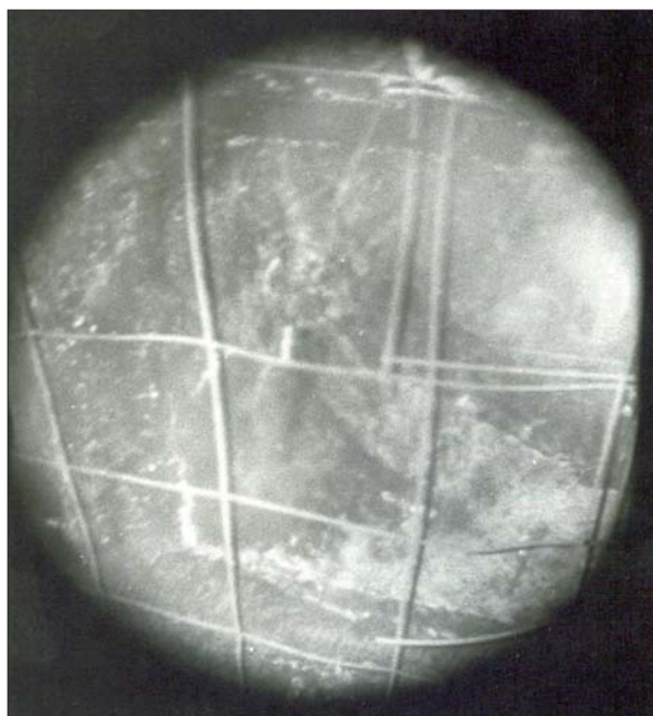
Рис. 11. Сожженный потолок в пом. 304/3. Фотография сделана с помощью перископа, введенного через скважину
