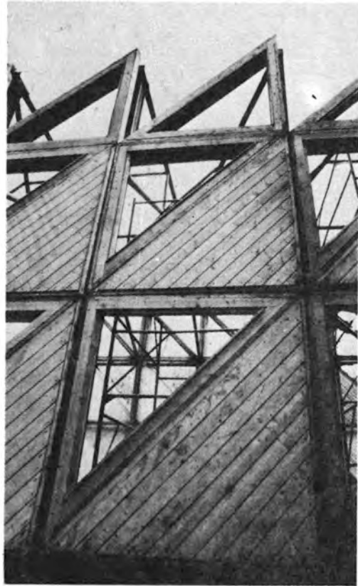
Фрагмент фасада в процессе строительства. Применение металлического каркаса и навесных деревянных многослойных панелей нескольких типов упростило монтаж Студии
