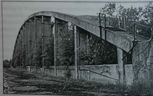
Конструкции старого Володарского моста в районе Новосаратовки
