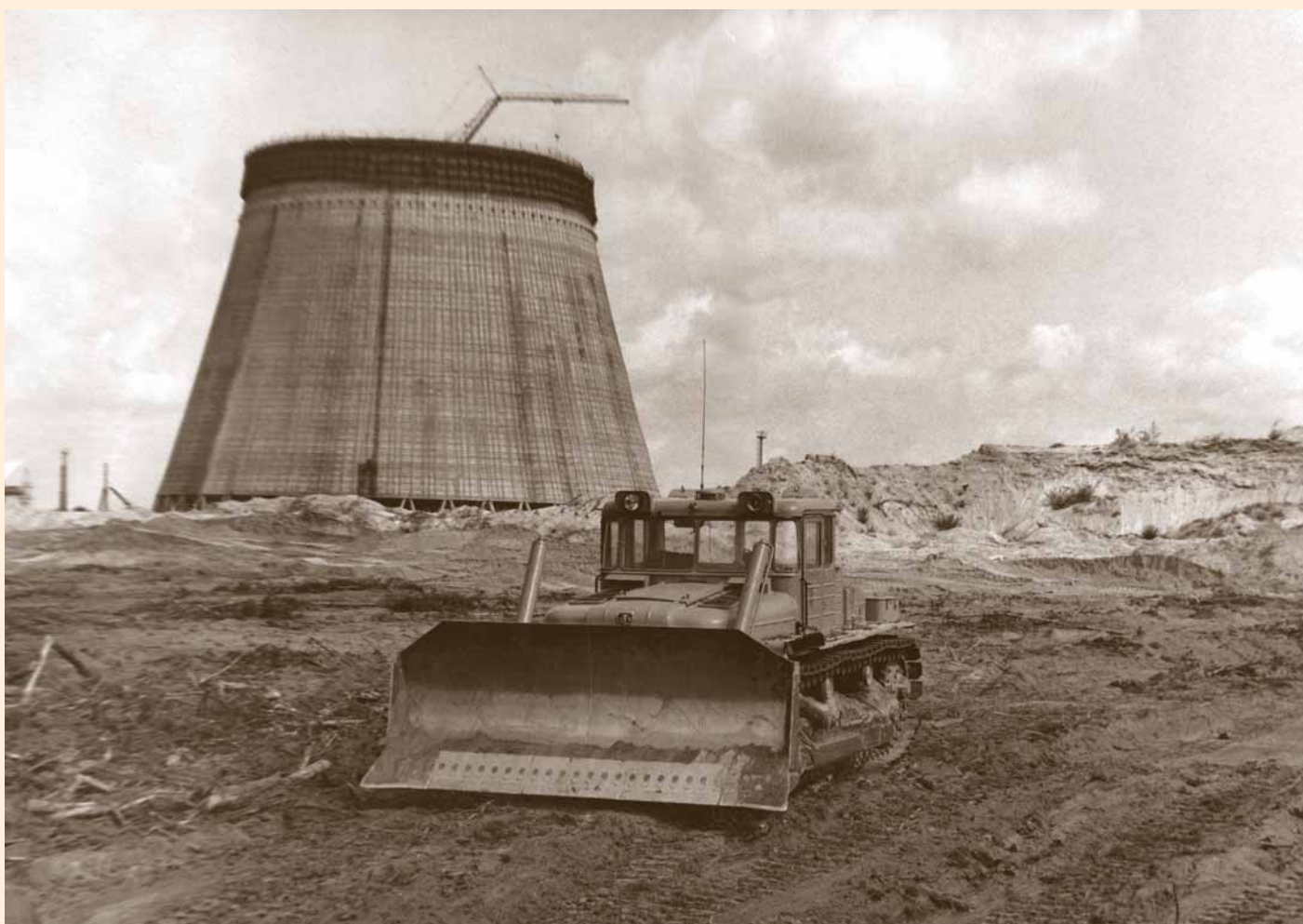
Радиуправляемый бульдозер ДЭТ-250 расчищает площадку вокруг 4-го аварийного блока. ЧАЭС, 12 июня 1986 года, до разрушенного реактора не более 250 м
