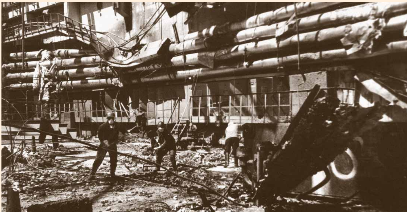
Ликвидаторы расчищают территорию у входа в машинный зал
