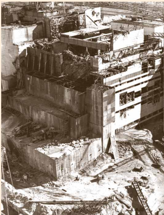
Начат монтаж труб перекрытия центрального зала, смонтирована первая секция 4-го яруса каскадной стены
