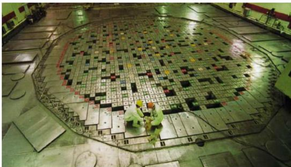
Верхняя крышка биологической защиты реактора РБМК-1000, конструкция «Е» («Елена»)
