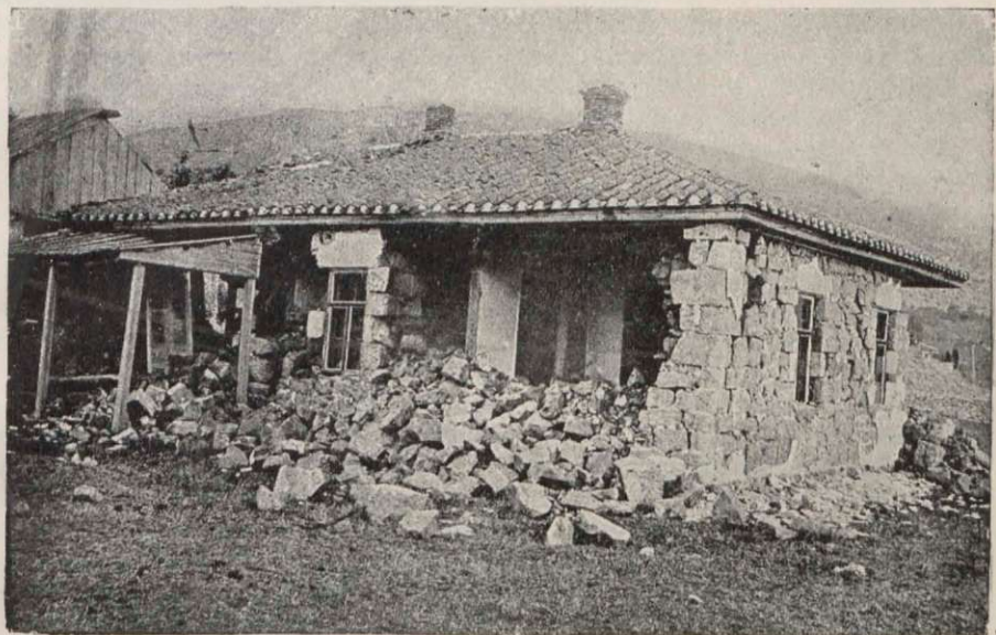
Балаклава, ур. „Левадки“, усадьба б. Ревелиоти (коммунхоз). Выпадение сев. стены и ю.-з. угла, расстройство каменной кладки
