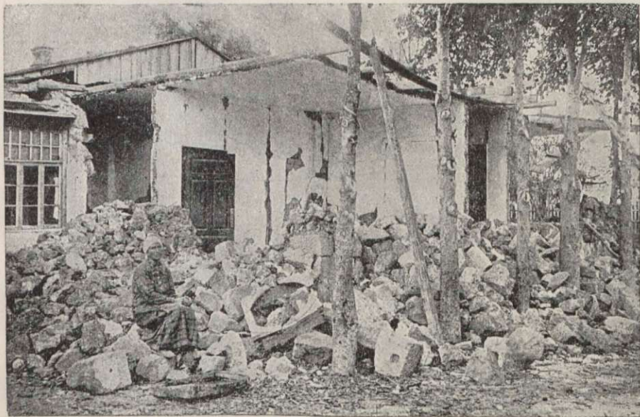
Балаклава, ур. „Левадки“, усадьба Будниковых. Разрушение каменных стен и неповрежденные фахферковые простенки
