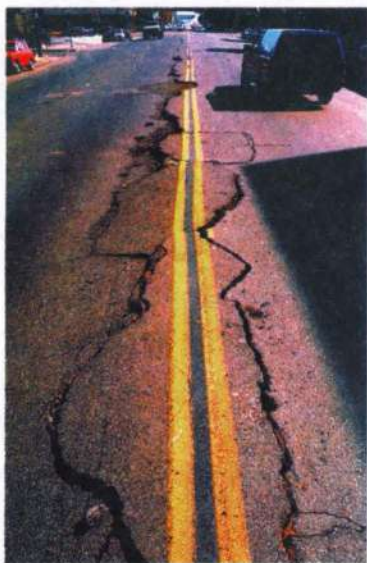
Трещины в дорожном покрытии как свидетельство современных подвижек земной коры.
