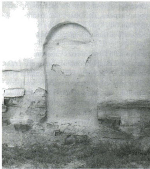
Заложенный вход в цоколе Симеоно-Аннинского собора
