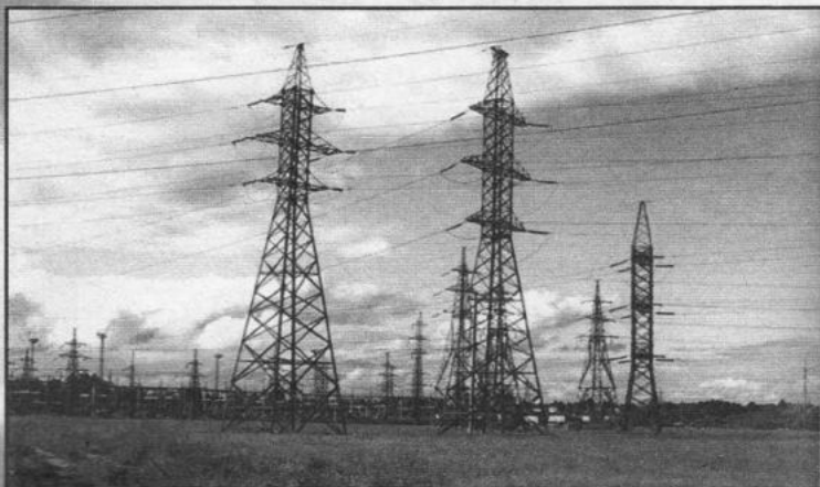
Линии электропередач, по проводам ток идет в дома и на промышленные предприятия
