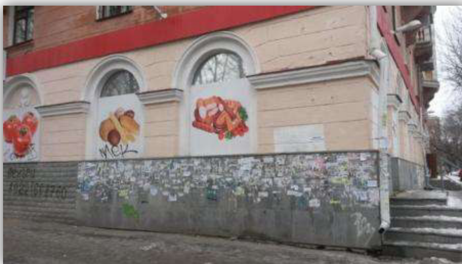
Рисунок 24 – Бытовой вандализм на стенах жилых домов
