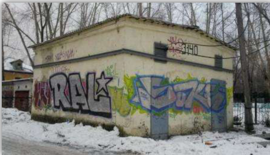
Рисунок 9 – Графический вандализм на стенах технических строений
