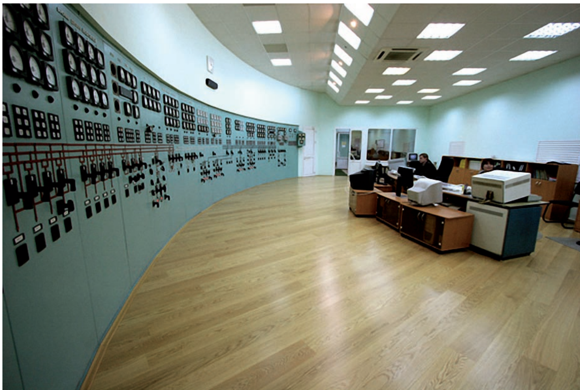
Воткинский гидроузел. Центральный пульт управления (ЦПУ) ГЭС
