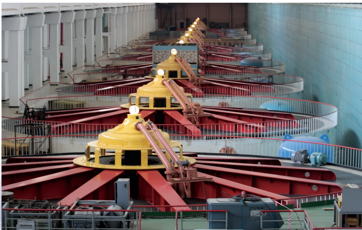
Машинный зал Воткинской ГЭС
