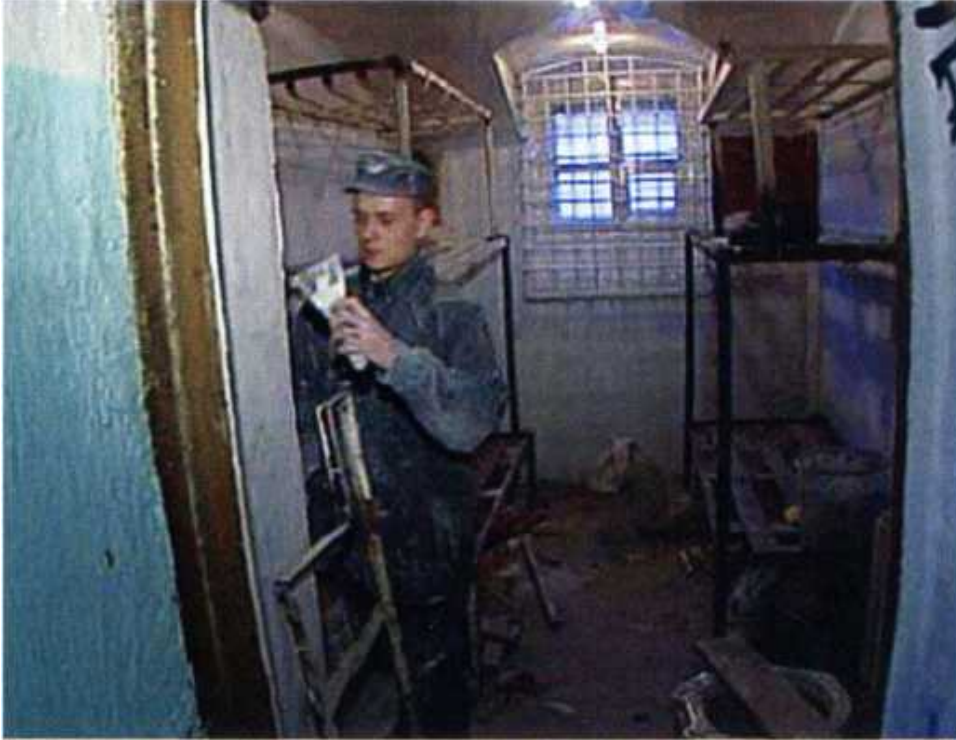
Ремонт камеры в более позднее время: шконки устроены уже не в два, а в три яруса.
