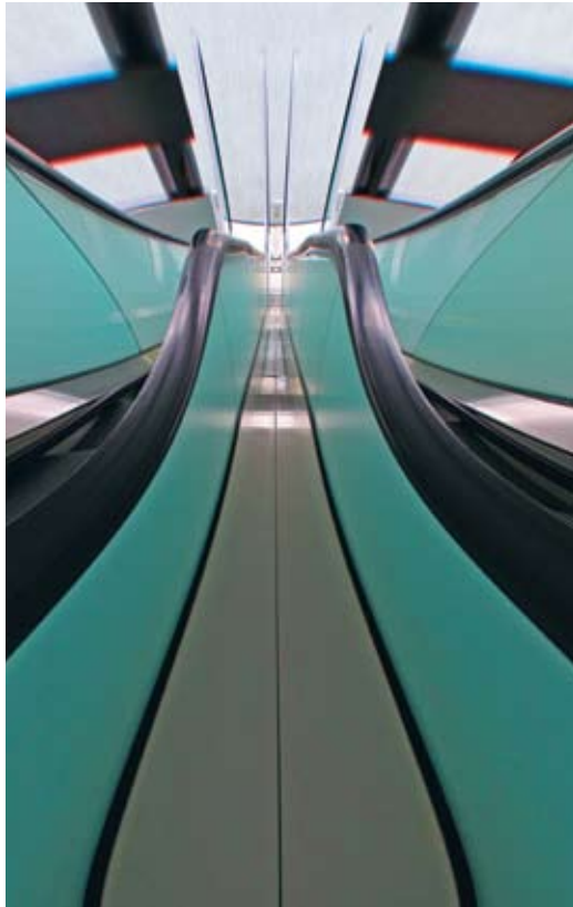
Эскалаторы стеклянных переходов
