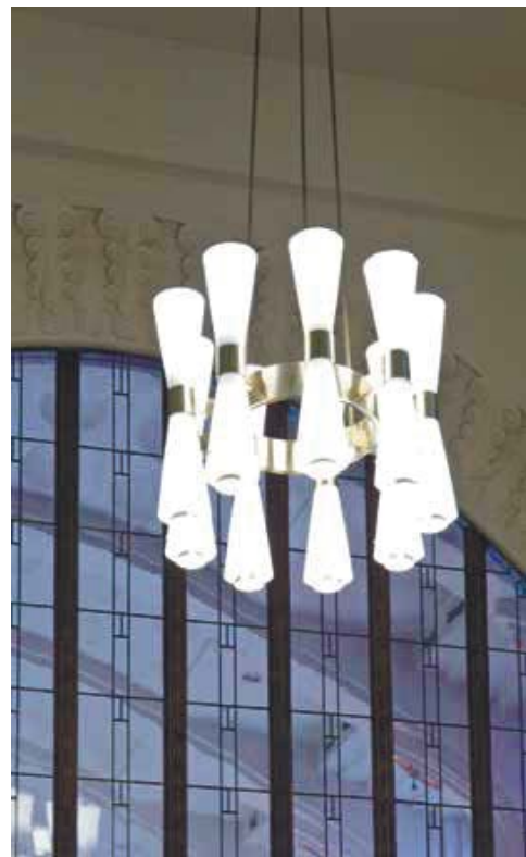
Потолочные светильники в вестибюле
