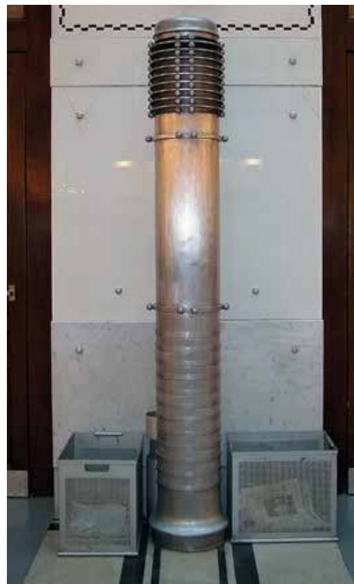
Тепловентилятор в операционном зале
