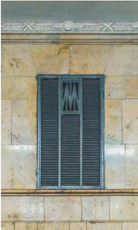
Станция метро «ЗИС» («Автозаводская»). Решетка вентиляции
