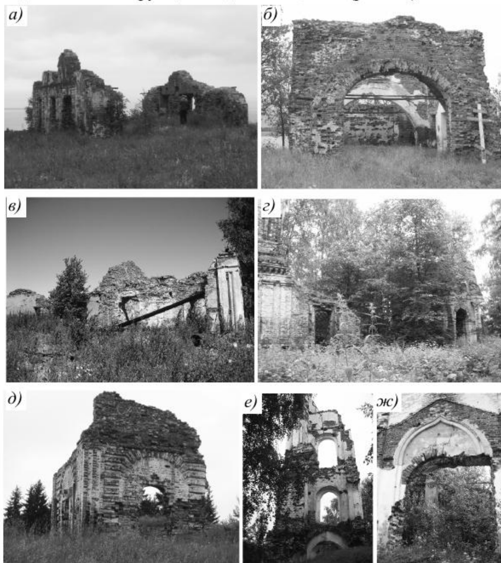
Рис. 51. Преднамеренные разрушения несущих конструкций: а – Борисоглебская церковь в с. Плишкино (1844 г.); б – церковь Вознесения в с. Горка (1854 г.); в – Сретенская церковь в с. Поповка (1763 г.), г – Благовещенская церковь в с. Скобеево (1792 г.); д – Преображенская церковь в с. Максимова (1829 г.); е – Николаевская Островская церковь (1749 г.); ж – Васильевская Романовская церковь в с. Васильевское (1862 г.)
