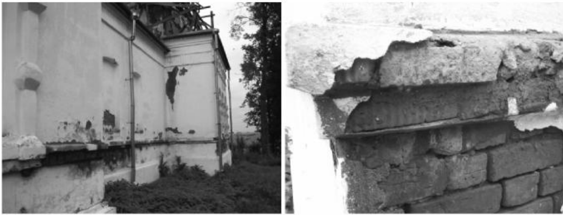
Рис. 73. Разрушение облицовочного слоя из цементно-песчаного раствора на реставрируемом объекте (церковь Бориса и Глеба в п. Ирма, 1830-е гг.)
