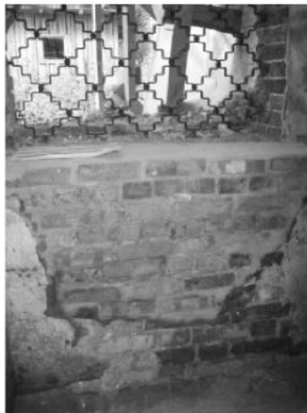
Рис. 69. Использование современного кирпича и цементно-песчаного раствора на участке реставрируемого здания (церковь Богоявления в с. Козохта, 1821 г.)
