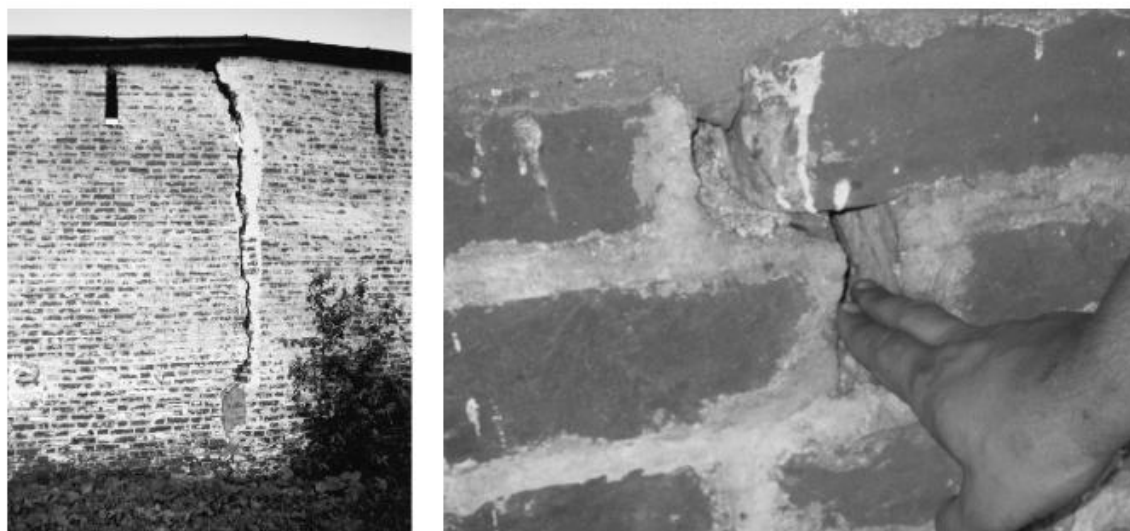
Рис. 6. Стены Нового Города Кирилло-Белозерского монастыря (величина раскрытия трещин до 5 см)
