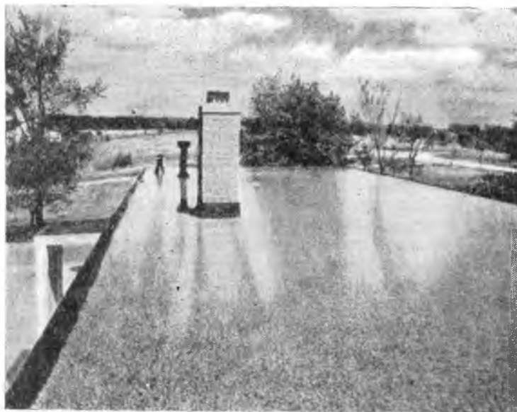
Рис. 160. Крыша, покрытая тонким слоем воды. Грин Редди Билт Хоумз, Рокфорд (Иллинойс)
