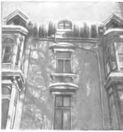
Рис. 258. Жилой дом в Монреале. Пример плохой изоляции крыши
