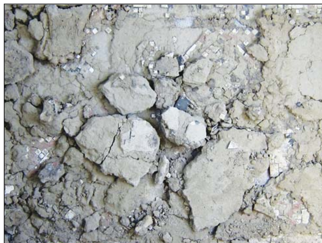
Рис. 5. Центральная часть фрагмента № 16 до реставрации. Видны сильные повреждения.
