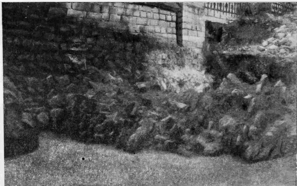
Рис. 5. Кладка упавшей западной стены.
