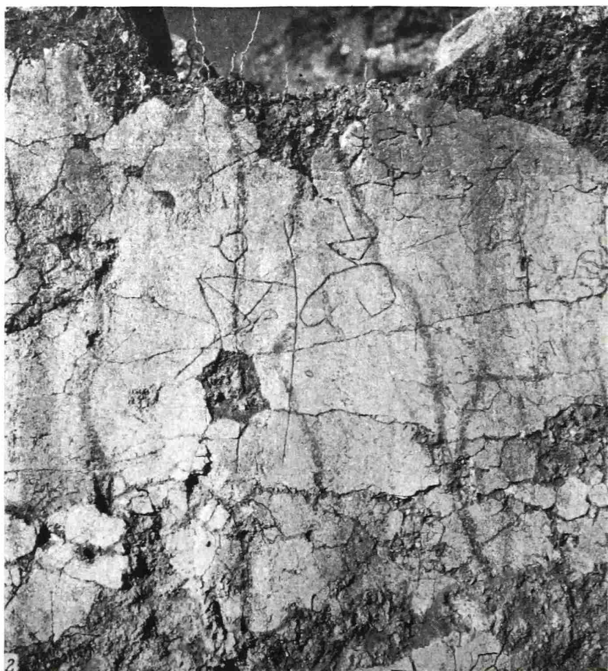
Рис. 4. Штукатурка с граффити на западной стене здания
